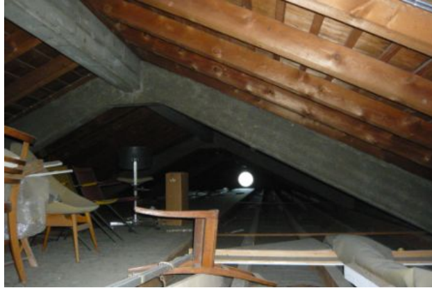
Dach nicht isoliert, Ziegeleindeckung
