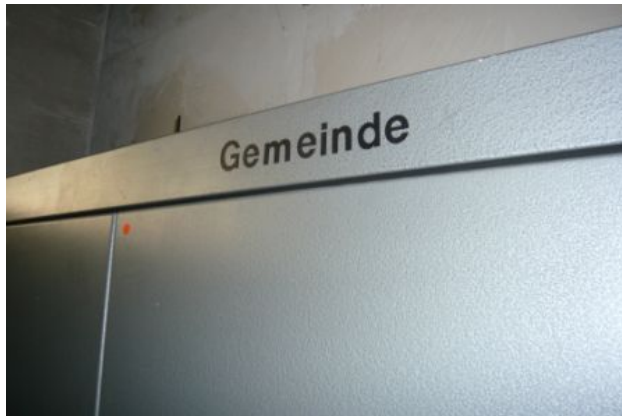
Stromverteilung für die Verwaltung
