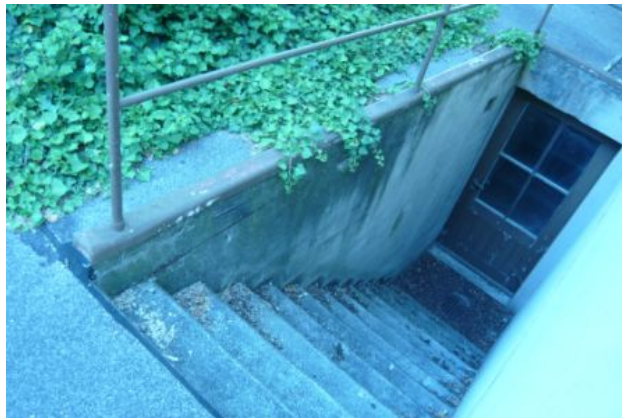
Treppenabgang mit Rissen
