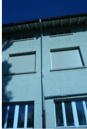
Verputzte Aussenfassade mit Rissen
