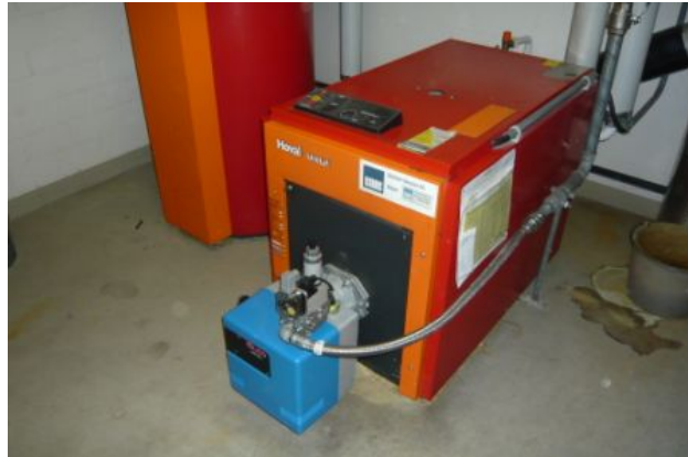
Gasheizung aus dem Baujahr, Brenner wurde ersetzt
